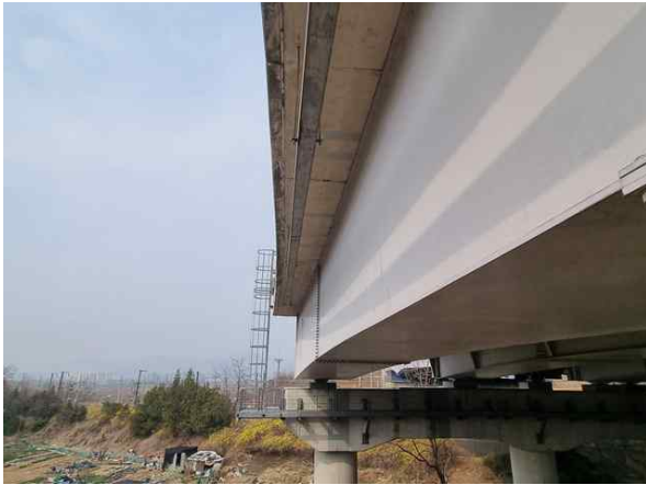
바닥관하면 S3 외측 캔틸레버 상태현황
