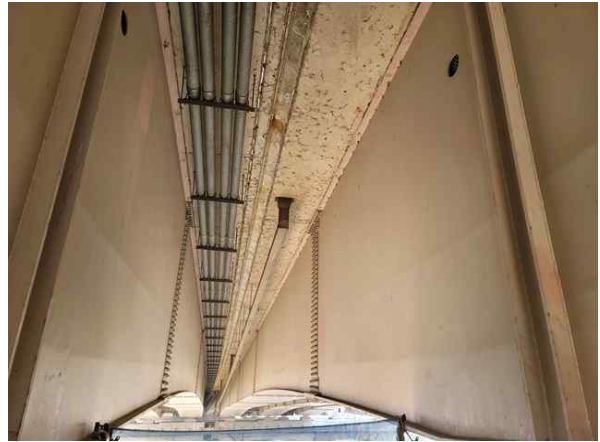
바닥관하면 S4 내측 캔틸레버 상태현황
