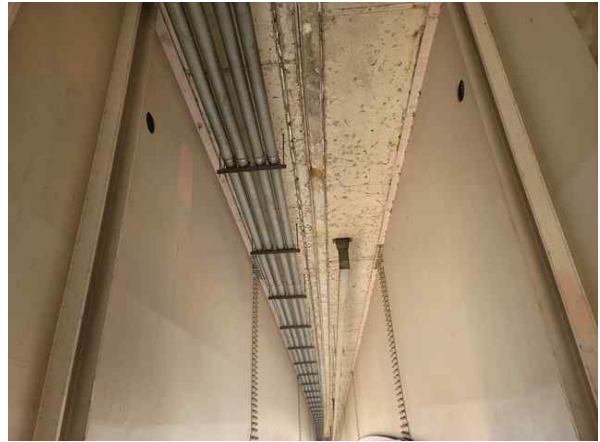
바닥판하면 S5 내측 캔틸레버 상태현황
